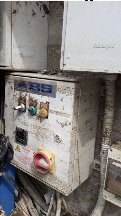
Secchezzo: livello raggiunto dall'acqua all'impianto idrovo – particolare quadro elettrico
