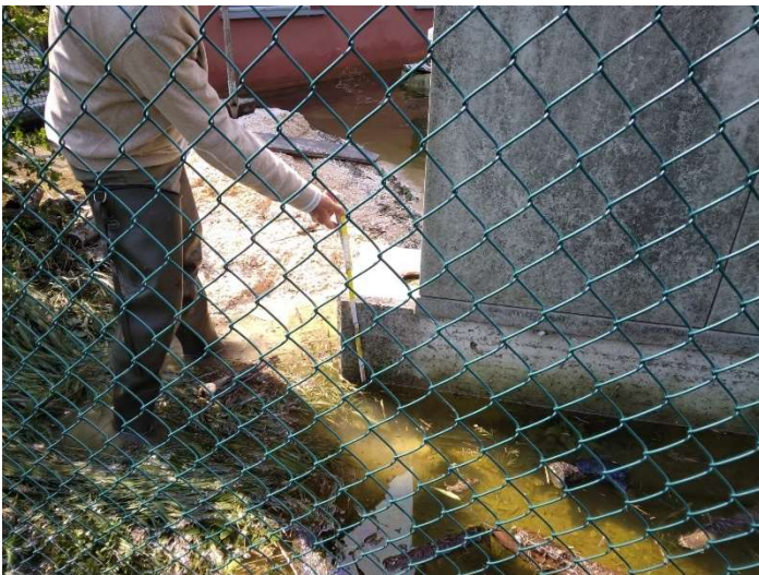
Fossette Riunite: allagamento al quadro elettrico
