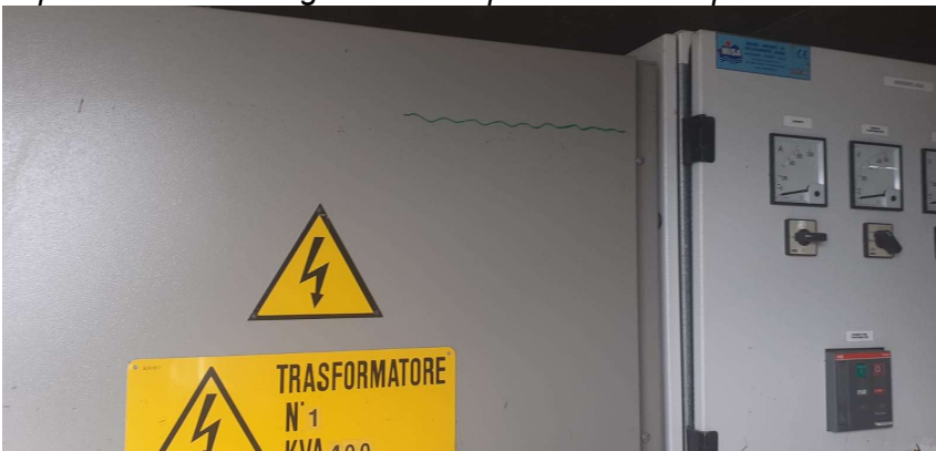
Idrovoro Ballirana – livello raggiunto dall'acqua
