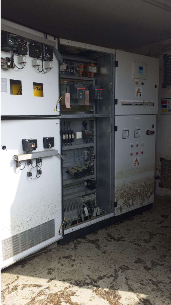
Impianto idrovoro Taglio Corelli – particolare dei quadri elettrici
