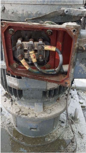
Raulla: particolare del motore allagato
