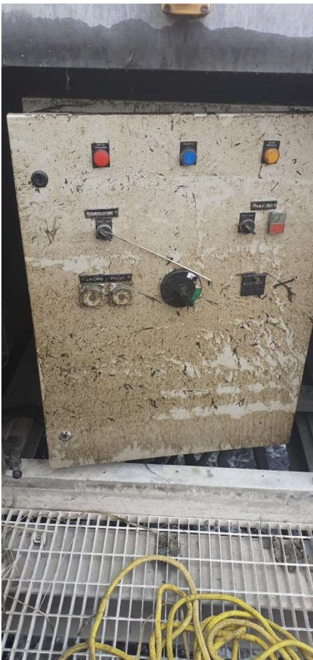
Sabbadina: quadro elettrico dello sgrigliatore
