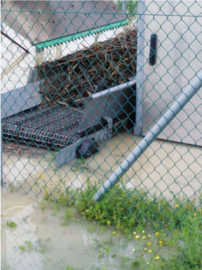
Impianto idrovoero Dane., sgrigliatore
