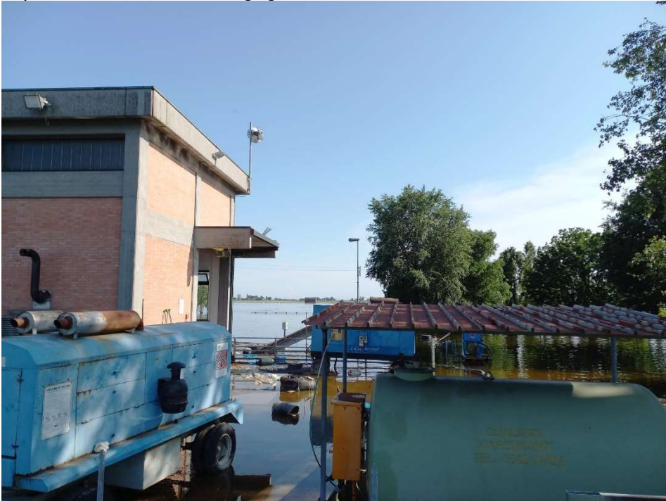
Impianto idrovoero Tratturo
