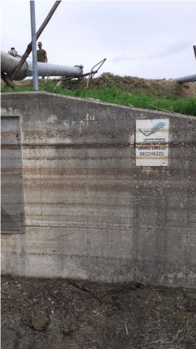
Secchezzo: livello raggiunto dall'acqua all'impianto idrovo
